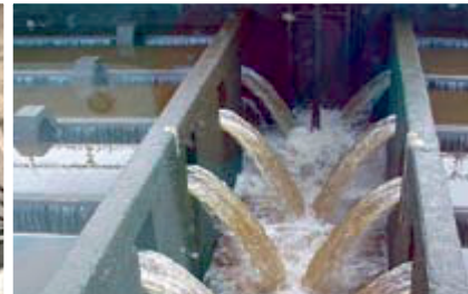
Станции и трубопроводы для очистки сточных вод
