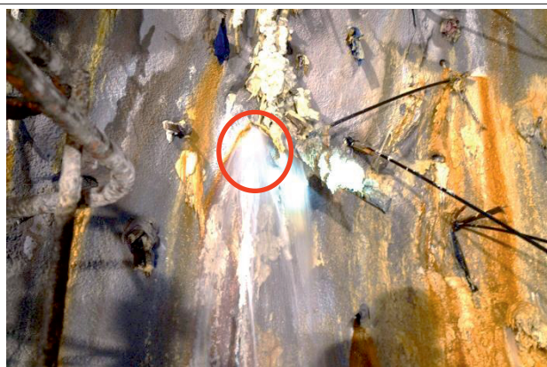
Осмотр объекта: Вода протекает через поверхность в одной точке
