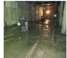
Протечки в подвальном помещении
